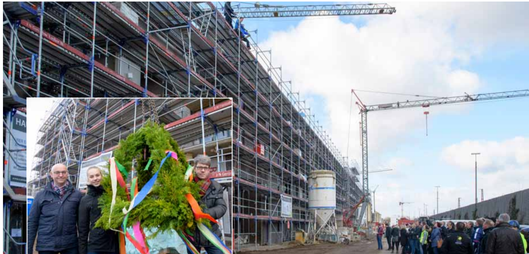
Gestern feierte die Firma Maszutt und Bauer mit Gästen und am Bau beteiligten Firmen Richtfest im Ilmenaugarten.
